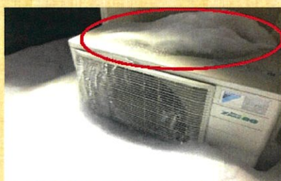
落雪による室外機の故障
