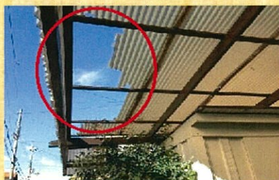
小屋・車庫の破損
