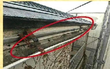
雨樋が外側に傾斜
