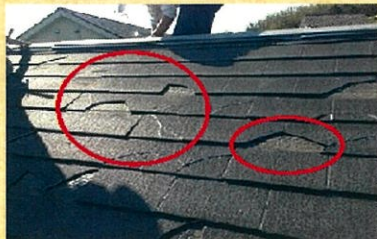
屋根材の割れ・欠落
