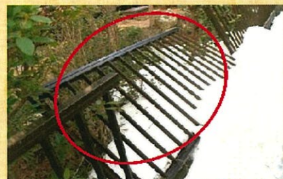
落雪によるフェンスの倒れ
